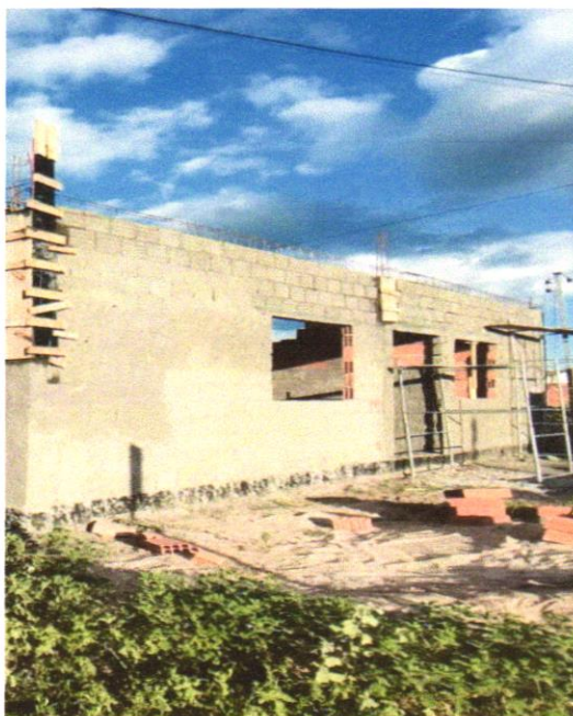
FOTO 03 – CHAPISCO APLICADO EM ALVENARIAS E ESTRUTURAS DE CONCRETO INTERNAS, COM COLHER DE PEDREIRO. ARGAMASSA TRAÇO 1:3 COM PREPARO EM BETONEIRA 400L. AF_06/2014
