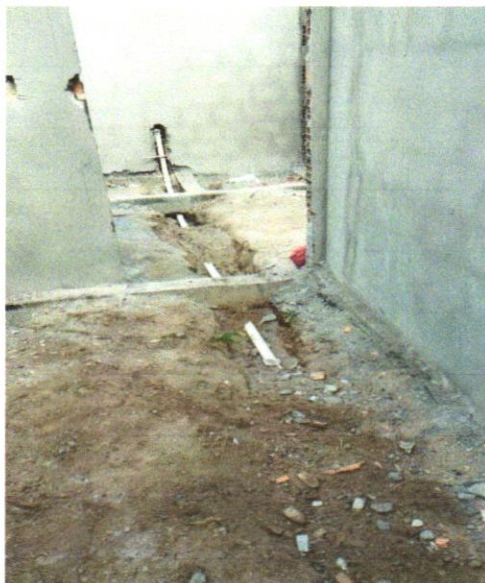
Foto 07 – (COMPOSIÇÃO REPRESENTATIVA) DO SERVIÇO DE INSTALAÇÃO DE TUBOS DE PVC, SÉRIE R, ÁGUA PLUVIAL, DN 75 MM (INSTALADO EM RAMAL DE ENCAMINHAMENTO, OU CONDUTORES VERTICAIS), INCLUSIVE CONEXÕES, CORTE E FIXAÇÕES, PARA PRÉDIOS. AF_10/2015
