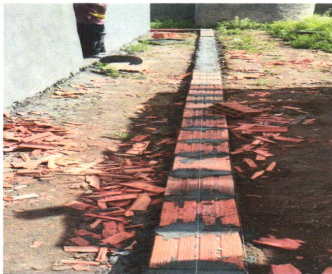
FOTO 01 – ALVENARIA DE VEDAÇÃO DE BLOCOS CERÂMICO FURADOS NA VERTICAL DE 9X19X39CM (ESPESSURA 9CM) DE PAREDES COM ÁREA LÍQUIDA MAIOR OU IGUAL A 6M 2 COM VÃOS E ARGAMASSA DE ASSENTAMENTO COM PREPARO EM BETONEIRA. AF_06/2014
